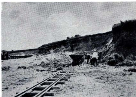
Fig. 21. Udgravning for 2. Spor Randers-Aalborg i Begyndelsen af Fyrreerne. Ved Beskæftigelsesarbejderne under Krigen vendte man ogsaa ved større Jordarbejder tilbage til Haandlæsningen. De 15 Mand paa Billedet læsser under gode Forhold 15—25 m 3 i Timen.
