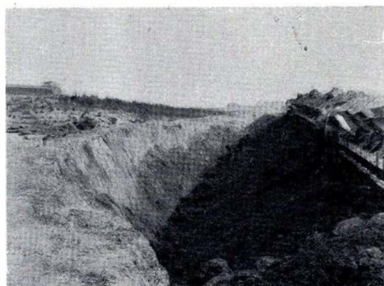
Fig. 26. Under Opfyldningen hen over den bløde Bund forekommer pludselige Udskridninger af Fylden med store Revnedannelser, som paany maa efterfyldes.
